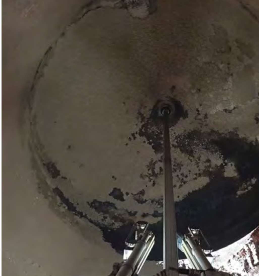
➤ Verschmutztes Silo vor der Reinigung
